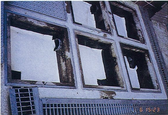
油水分離槽 Kシート
